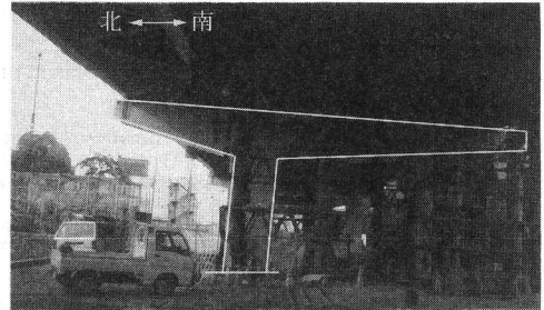
写真-1 P352 の損傷状況
