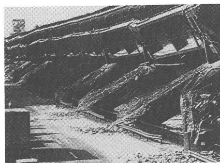
写真-1 阪神高速道路3号神戸線被害
