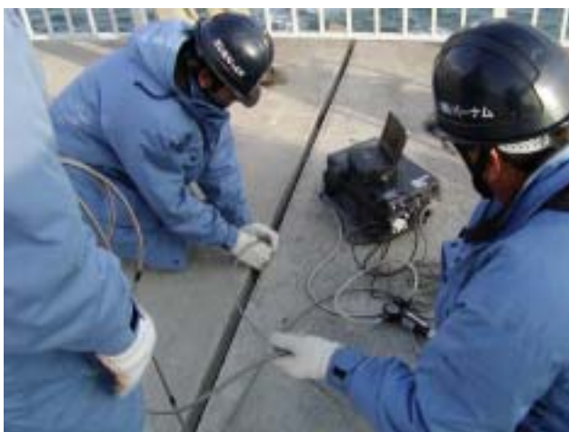
東側突堤 11-12 ケーソン目地部
