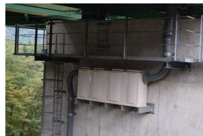
写真 3 油水分離ます
