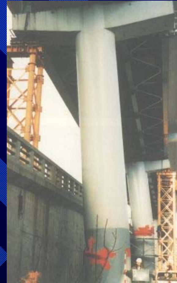
・大きく傾いた鋼製橋脚
