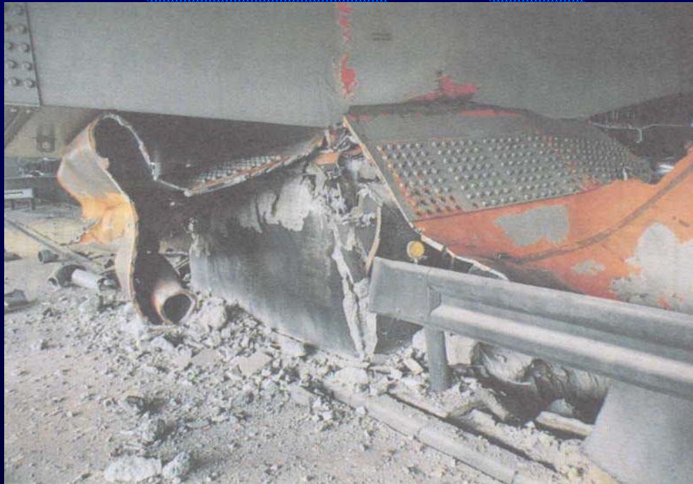
・倒壊した鋼製橋脚
