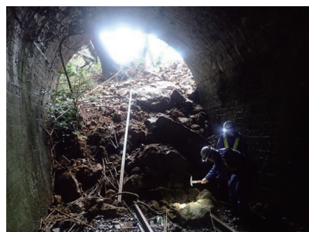
写真5 のと鉄道乙ヶ浦トンネルの被災状況 (提供: JR西日本)
