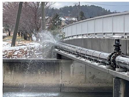
写真6 七尾市の水管橋の漏水 (提供: 名古屋市上下水道局)
