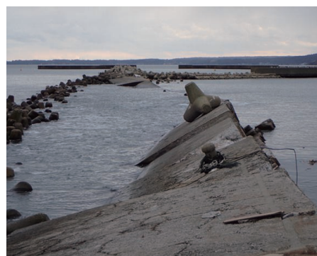
写真8 津波で被災した珠州市飯田港の堤防
