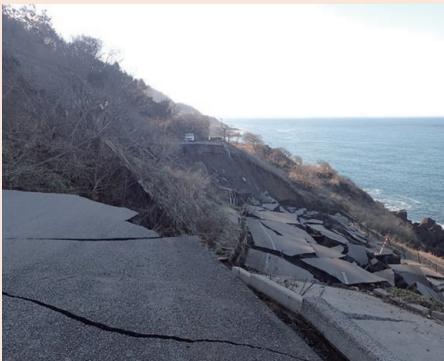
写真3 崩落した輪島市北岸の道路
