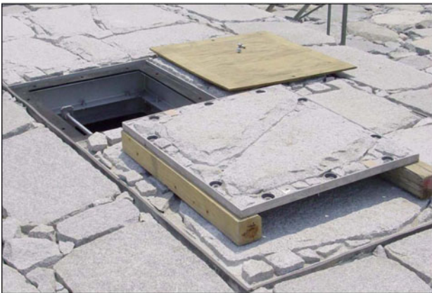
図-18 機械室上蓋（埋め込み式）
