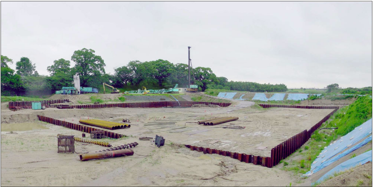
図-5 施工ヤード（シートパイル内に堰本体を施工。左端に、旧大井手堰遺構。石井樋大井手堰は、部分的な改築ではなく、新たな築造である。）
