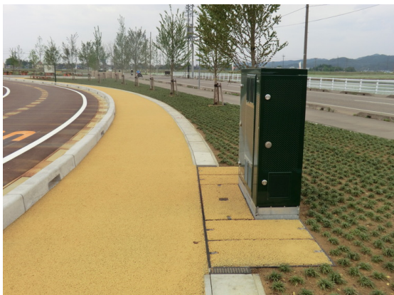
供用中の小型ボックス：新潟県見附市
